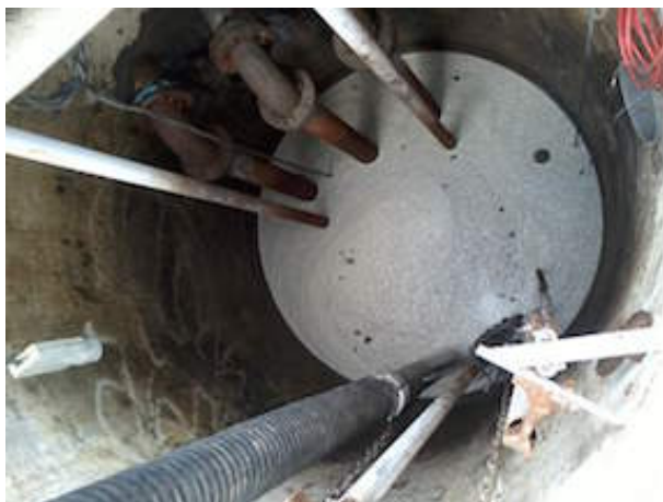
Pollution au réseau
